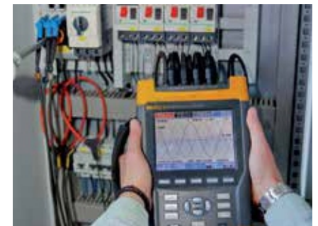
Medición de energía Energy measurement
